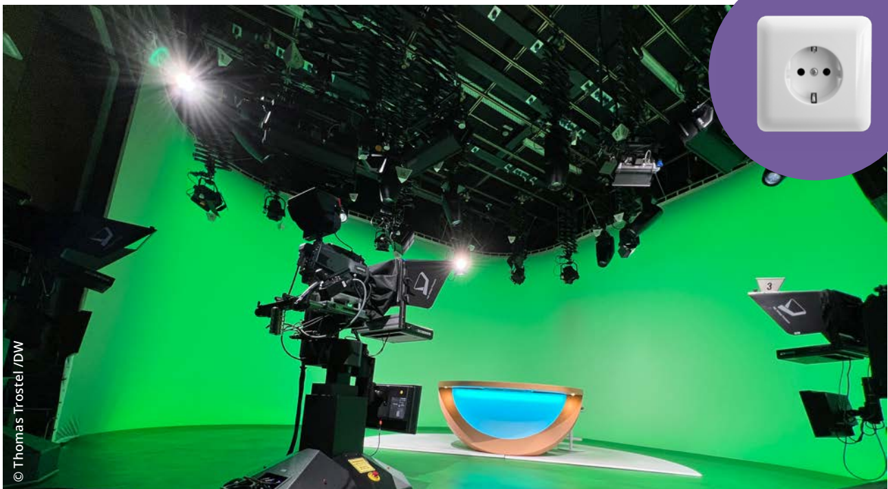
Abbildung 5: Neue energiesparende LED-Beleuchtung im Berliner Studio 2
